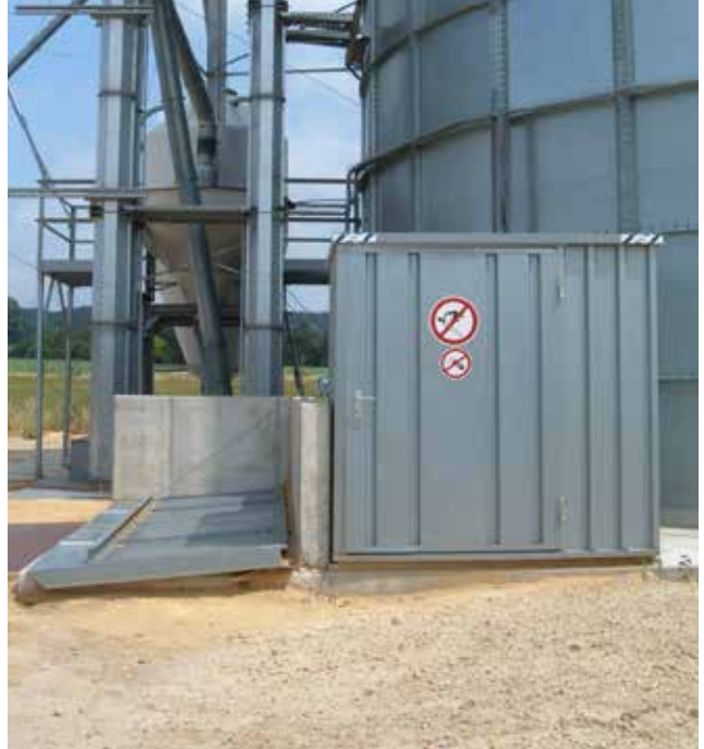
Einhausung für eine externe Schaltzentrale
